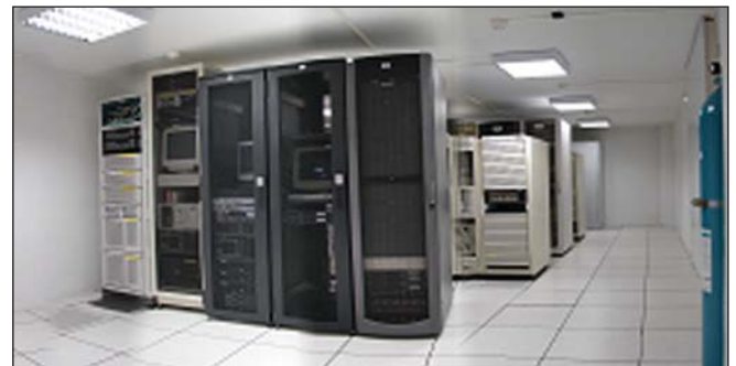
Une de nos quatre salles aménagées haute sécurité pour l'hébergement de serveurs
